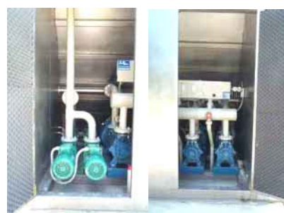
Locale macchine insonorizzato e protetto con porte di chiusura
