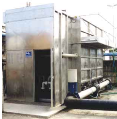
Flottatore lamellare ad aria dissolta con capacità di trattamento pari a 220.000 l/h, installato presso un impianto Consortile.
