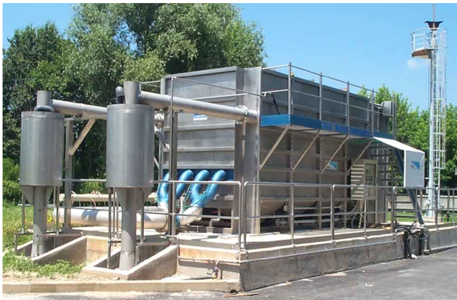
Flottatore lamellare ad aria disciolta con capacità di trattamento pari a 350.000 l/h, nell'abbattimento dei valori di COD, SST e Fosforo a valle di un impianto biologico, realizzato ed installato dalla Bio Mass Impianti S.r.l.
