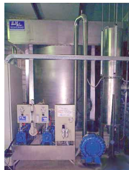
Flotto-filtro ad aria dissolta con capacità di trattamento pari a 40.000 l/h progettato e realizzato dalla Bio Mass Impianti S.r.l. per il recupero tecnologico delle acque reflue da industria alimentare, a valle di trattamento biologico.
