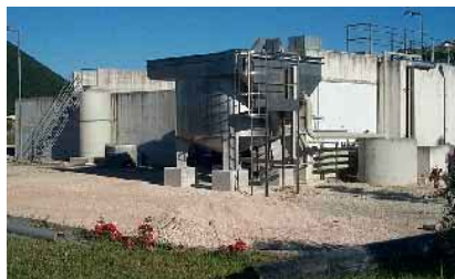
Flottatore ad aria dissolta installato in testa ad un impianto Municipale per l'abbattimento dei grassi in eccesso
