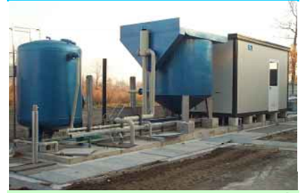
Flottatore ad aria dissolta con capacità di trattamento pari a 30.000 l/h e box impianti indipendente accorpante tutte le macchine di servizio, nel trattamento di reflui da Lavanderia Industriale.
